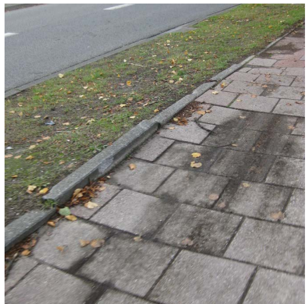
Figur 21 – Flisebelægning kan medføre nedsat komfort for cyklister og øget utryghed.
