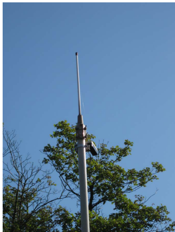
Figur 11 – Regnsensor i toppen af en mast.
